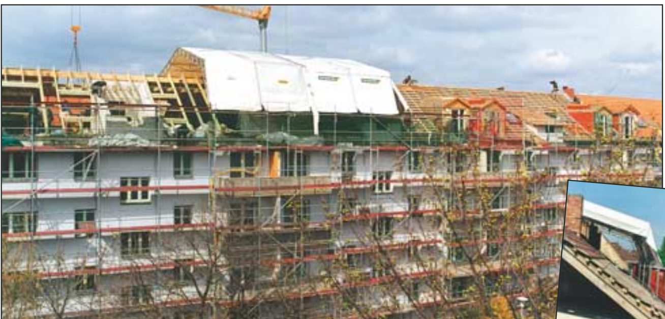
Aufstockung einer kompletten Etage schafft zusätzliche Wohnungen und steigert die Attraktivität der Wohnanlage
